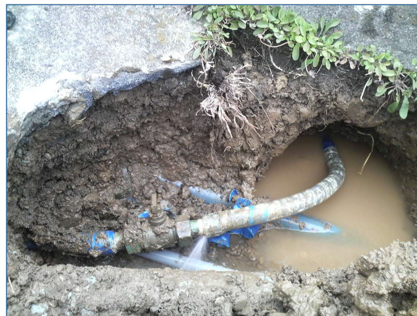
鉛給水管の漏水状況
