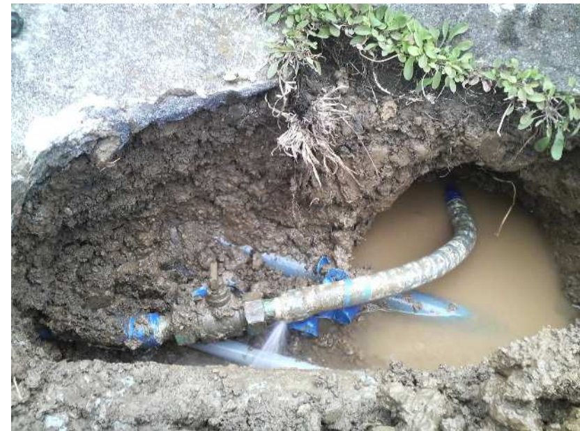
鉛給水管の漏水状況
