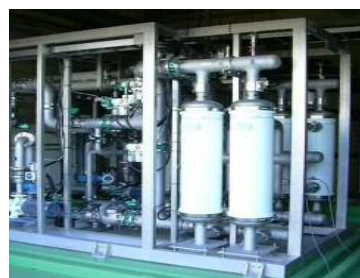
走水水源地膜ろ過設備
