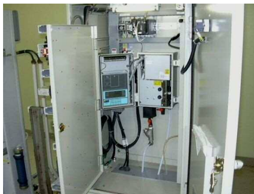
蛇口・配水池の自動水質監視装置
