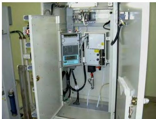
蛇口・配水池の自動水質監視装置
