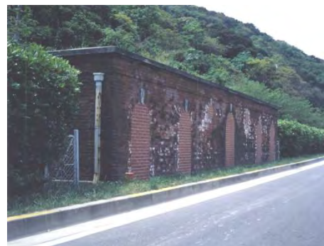
走水水源地（湧水埋渠取水施設）
