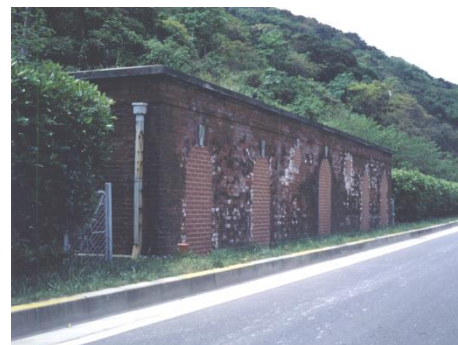
走水水源地（湧水埋渠取水施設）
