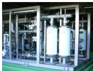
走水水源地膜ろ過設備
