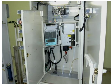
蛇口・配水池の自動水質監視装置
