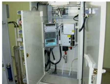
蛇口・配水池の自動水質監視装置
