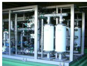
走水水源地膜ろ過設備
