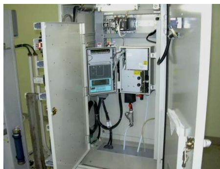
蛇口・配水池の自動水質監視装置
