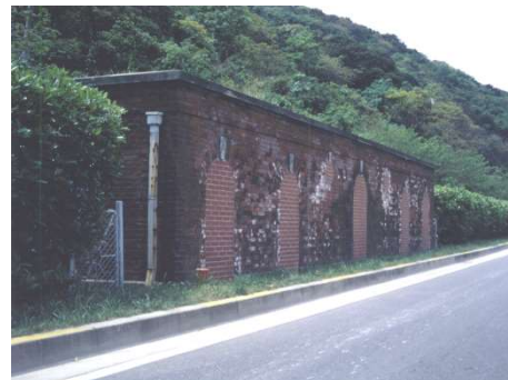
走水水源地（湧水埋渠取水施設）
