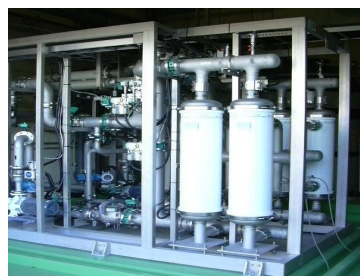
走水水源地膜ろ過設備
