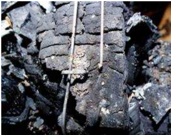
ステップル止めされた屋内配線が短絡
