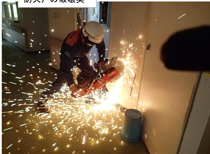
防火戸の破壊実
