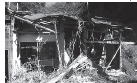
管理が行き届かず荒れた空き家
