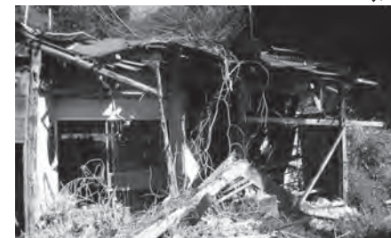
管理が行き届かず荒れた空き家
