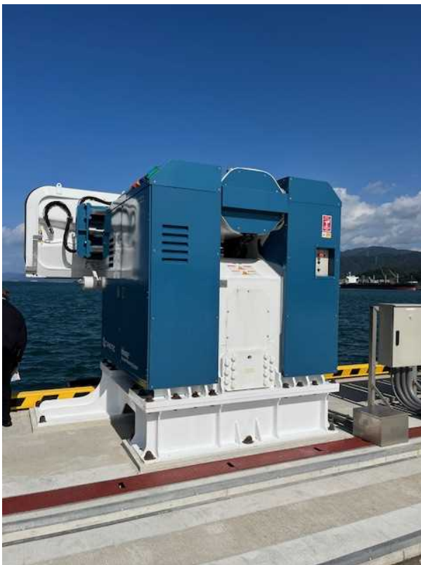
▲実証実験が行われている自動係留装置
