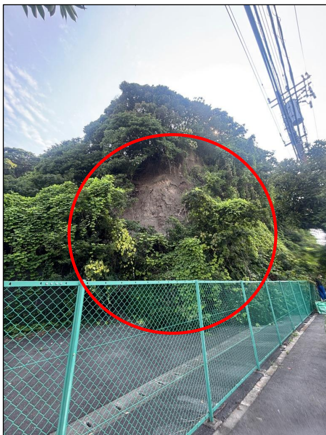
写真1 発生場所（崩落箇所）
