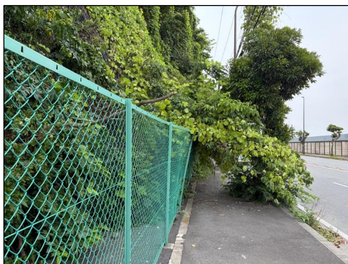
写真3 倒木が歩道をふさいだ状況 およびフェンスの被害状況
