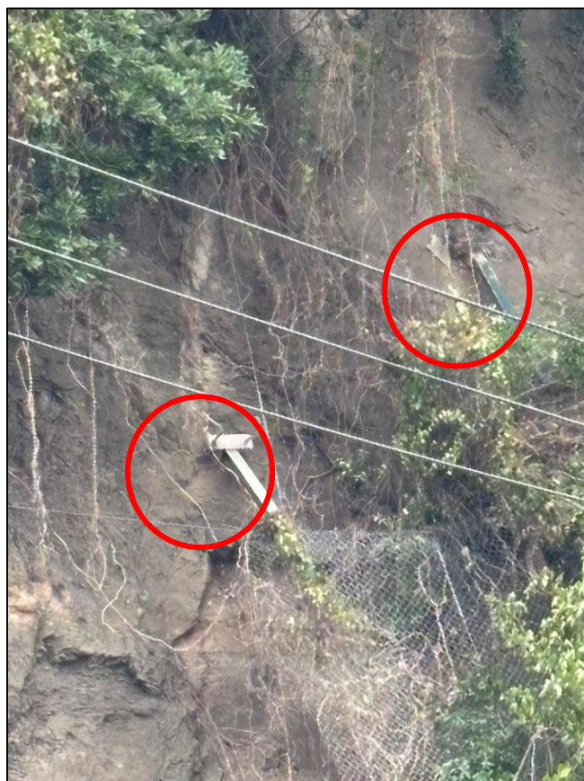
写真2 落石防止網のアンカーが外れた状況
