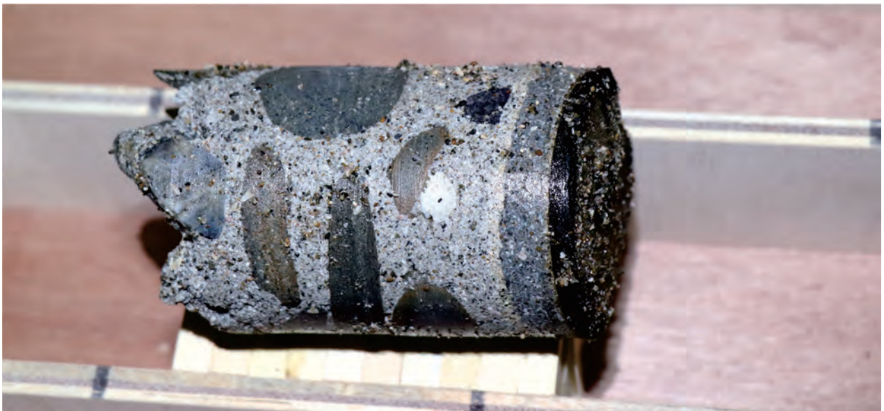
2. 第二隧道天井コンクリートコア・外背塗布アスファルト (現状調査)
