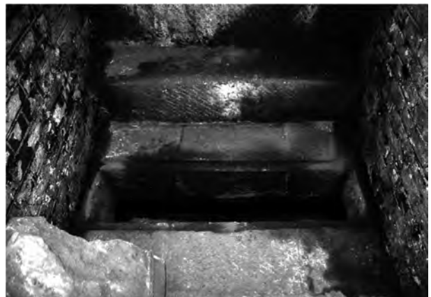
8. 地下階段前集水溝
