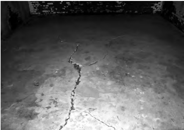
5. 第一掩蔽部右室床面の隆起及び亀裂の状況
