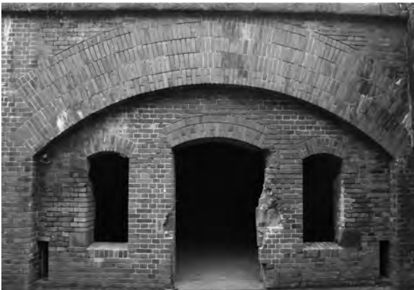
7. 第一掩蔽部右室出入口安山岩・煉瓦の欠損
