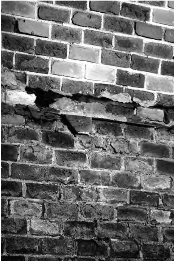
3. 現状調査・隧道天井煉瓦浮き及び目地抜け状況
