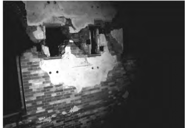
4. 現状調査・吹抜室妻壁破損状況
