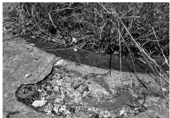
2. 走水低砲台跡・外縁を鉄板で被覆された溝
