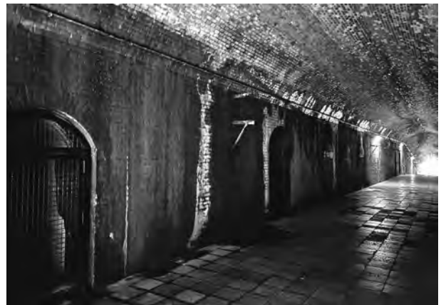
6. 隧道内部漏水の様子
