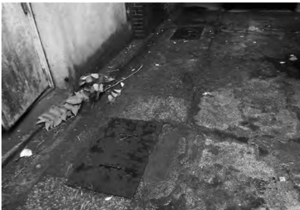
7. 管理施設 (側溝蓋欠損部整備前)
