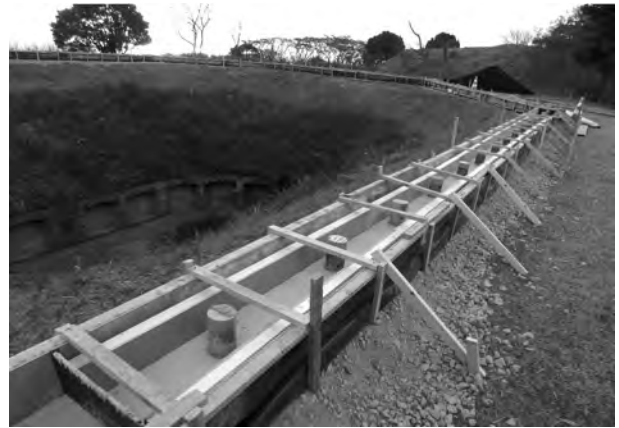
6. 雨水流入防止工（侵入防止柵基礎）
