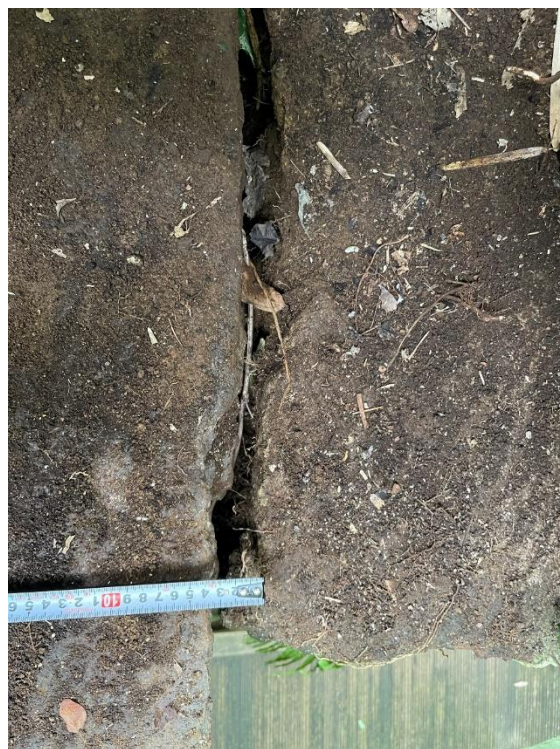
復旧後（上から、隙間 約 3 cm）
