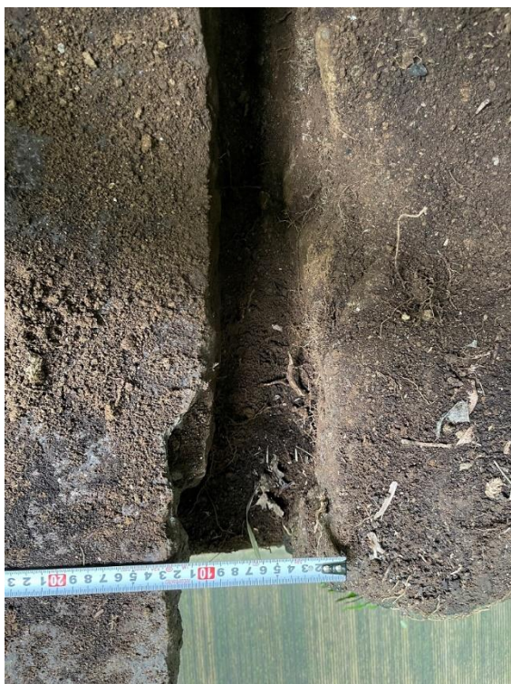
復旧前（上から、隙間 約 13cm）
