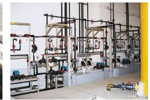
次亜塩素酸ナトリウム注入機
