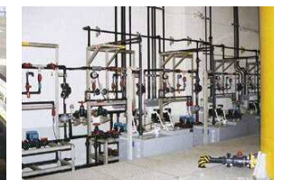
次亜塩素酸ナトリウム注入機
