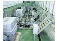
●大矢部ポンプ所
