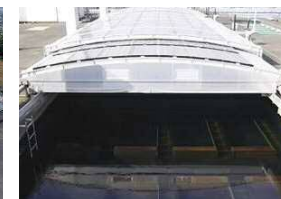
活性炭吸着池
