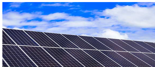
▲①②太陽光発電システム（パネル）
